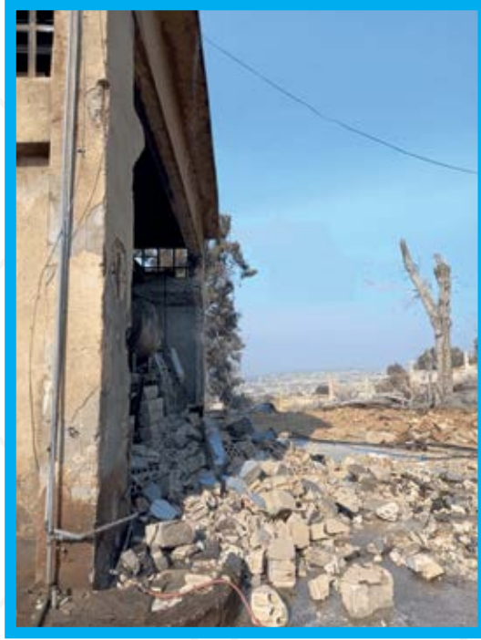
Saldırı sonrasında, su istasyonunun 1 nolu tesisinin doğu cephesi.
