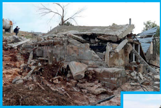
Saldırı sonrasında, su istasyonunun 2 nolu tesisi.
